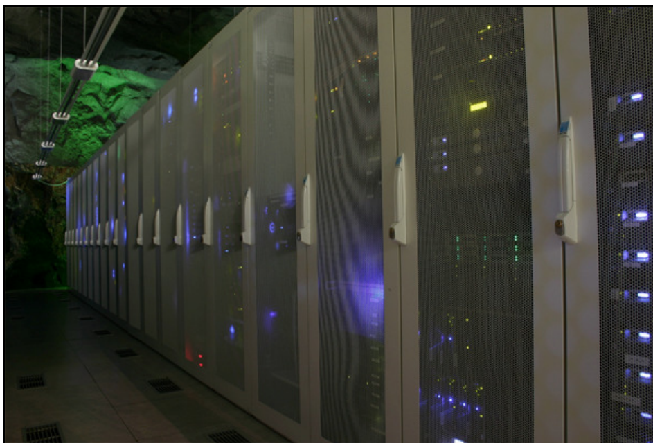
Bahnhofs serverhall "Pionen"
